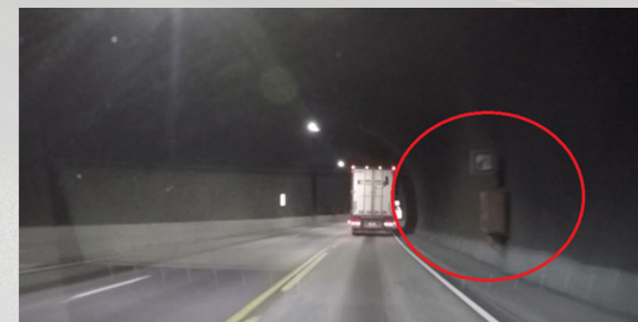
Bømlafjordtunnelen: Manglende lys i skilt over nødskap. Det er usikkert om nødskapet er i drift eller ikke. Ifølge beredskapsplan skal nødutstyr være i drift gjennom hele anleggsperioden.
