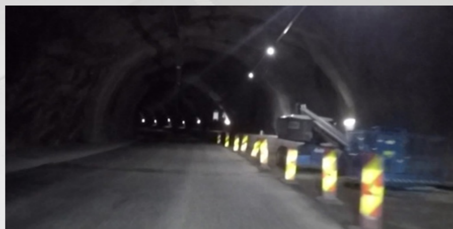
Freheimstunnelen: Lift parkert tett inntil vegkanten. Fare for påkjørsel, ingen sikring. Fartsgrensen er 60 km/t.
