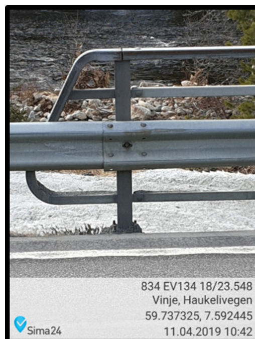
Bilete 3: Manglande boltar i overgang til bru
