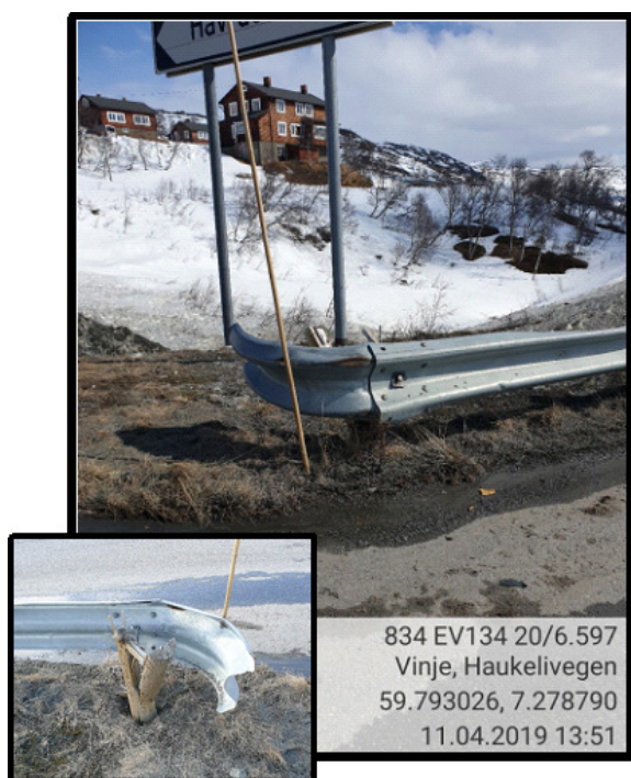
Bilete 4: Trafikkfarleg endeavslutning i 80-sone, manglande boltar og skadd stolpe
