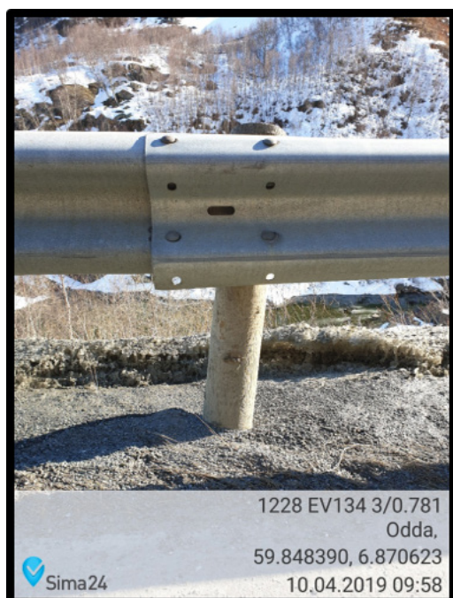
Bilete 2: Eksempel på rekkverk med manglande boltar
