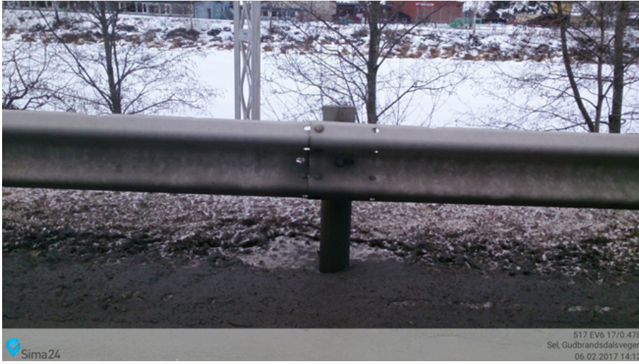
E6 Sel, Gudbrandsdalvegen. Rekkverket er feil sammenføyd og mangler bolter.
