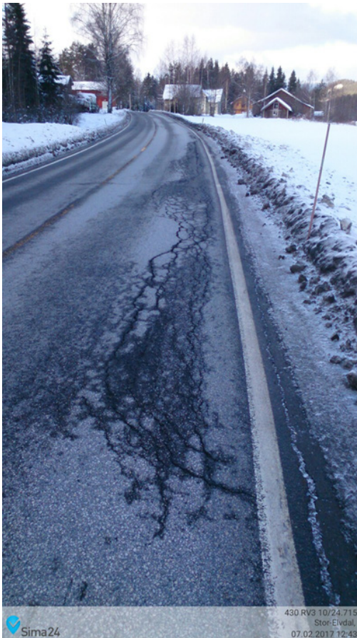
Rv 3 Stor Elvdal. Omfattende krekering av vegdekke, setninger i hjulspor.
