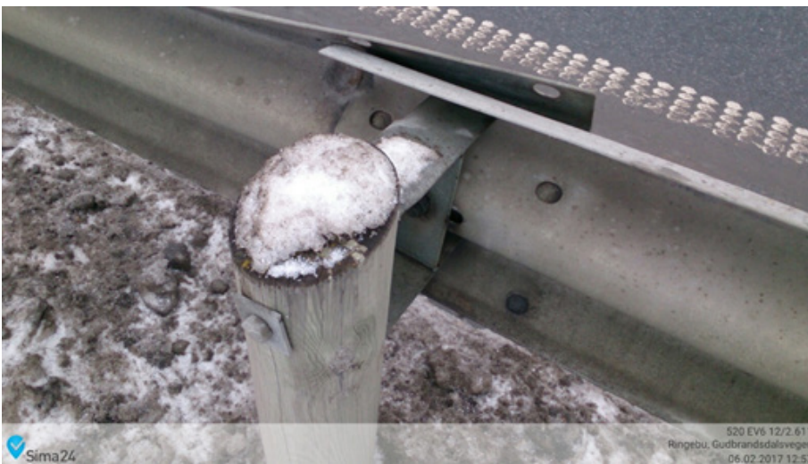
E6 Ringebu, Gudbrandsdalsvegen. Alle boltene mangler i rekkverket.
