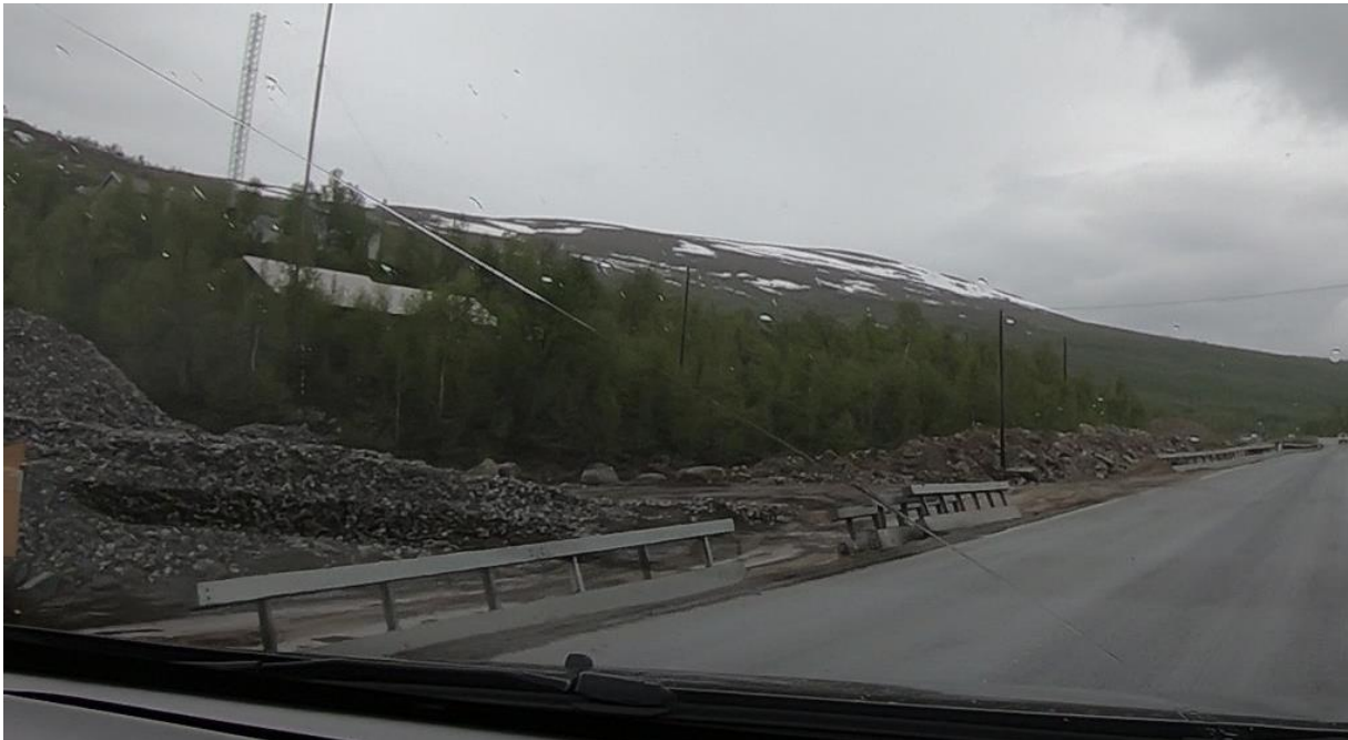
Påkjørselsfarlige element i sikkerhetssonen, rekkverkselement (E6 Helgeland)
