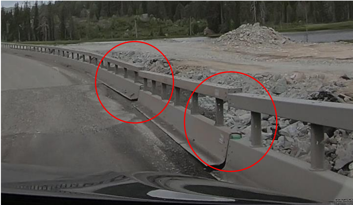
Manglende forankring mellom rekkverkselement (E134 Åmot- Seljord)
