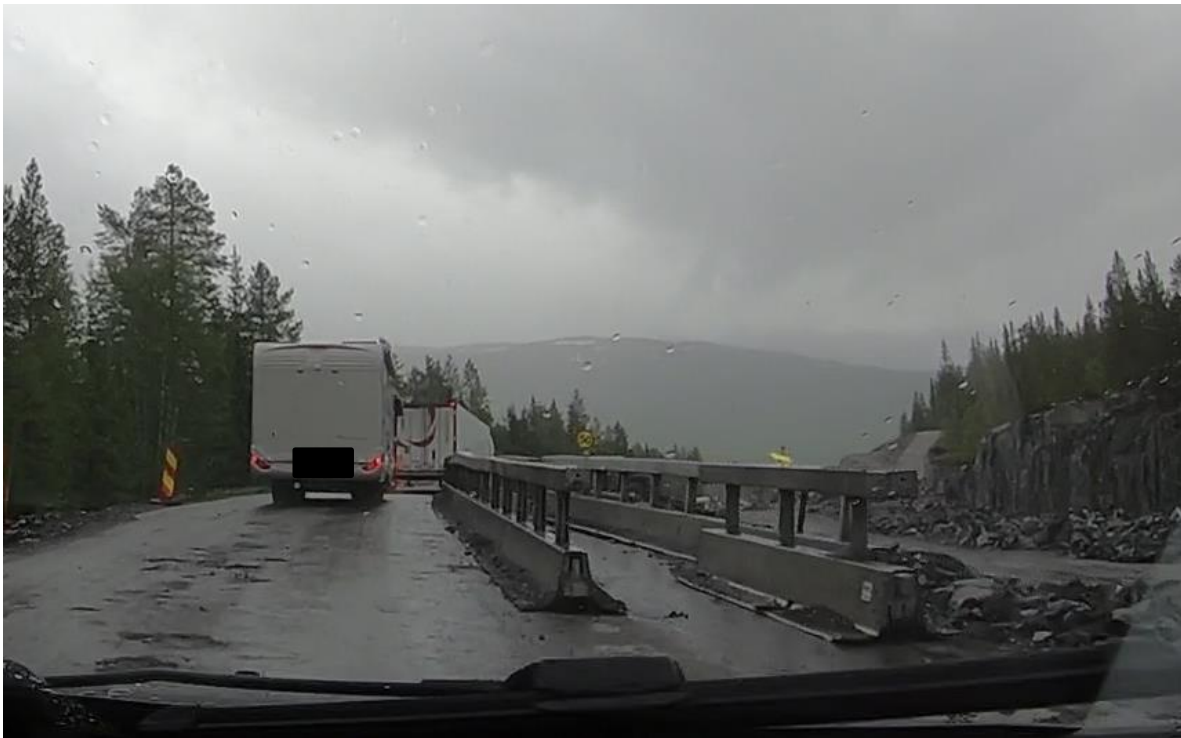
Trafikkfarlige rekkverkselementer (E6 Helgeland)
