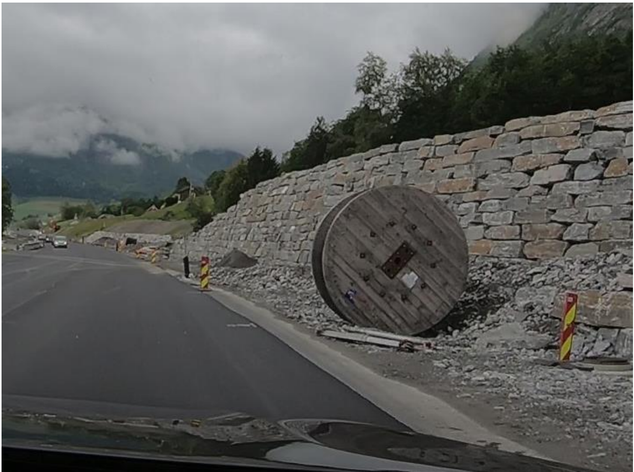
Påkjørselsfarlig element i sikkerhetssonen, kabeltrommel (E39 Bjørset- Skei)
