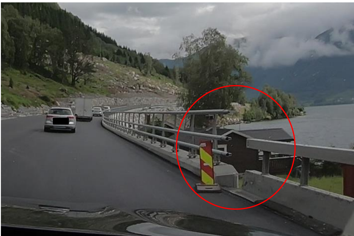
Trafikkfarlig rekkverksende (E39 Bjørset- Skei)
