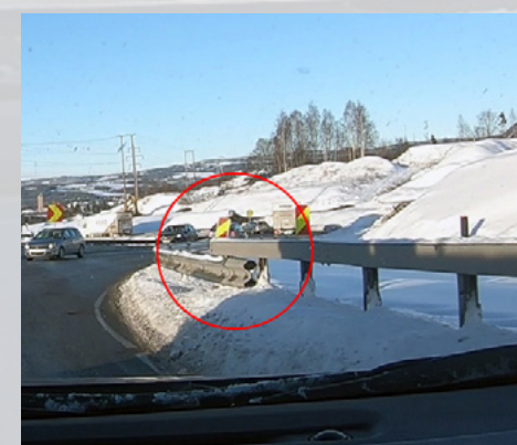
Rekkverks-ende som ikke er tilstrekkelig sikret, mot fartsretningen
