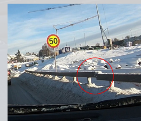
Mangelfull innfesting mellom rekkverkselement. Det er observert et stort antall slike på strekningen.
