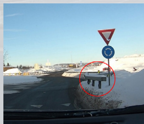
Ikke godkjent rekkverks-overgang mellom eksisterende og midlertidig rekkverk, mot fartsretningen, i nedoverbakke
