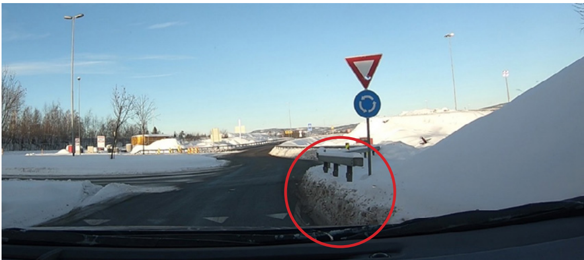
Bilde 4: Rekkverks-ende som ikke er tilstrekkelig sikret, mot fartsretningen
