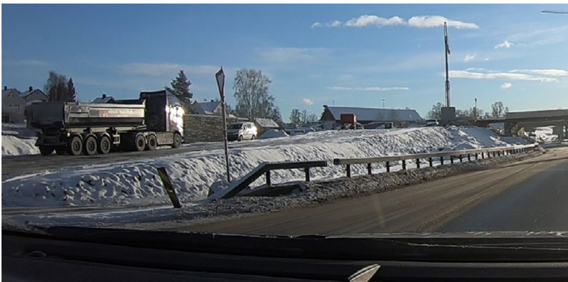
Bilde 6: Mangelfull innfesting mellom rekkverkselement
