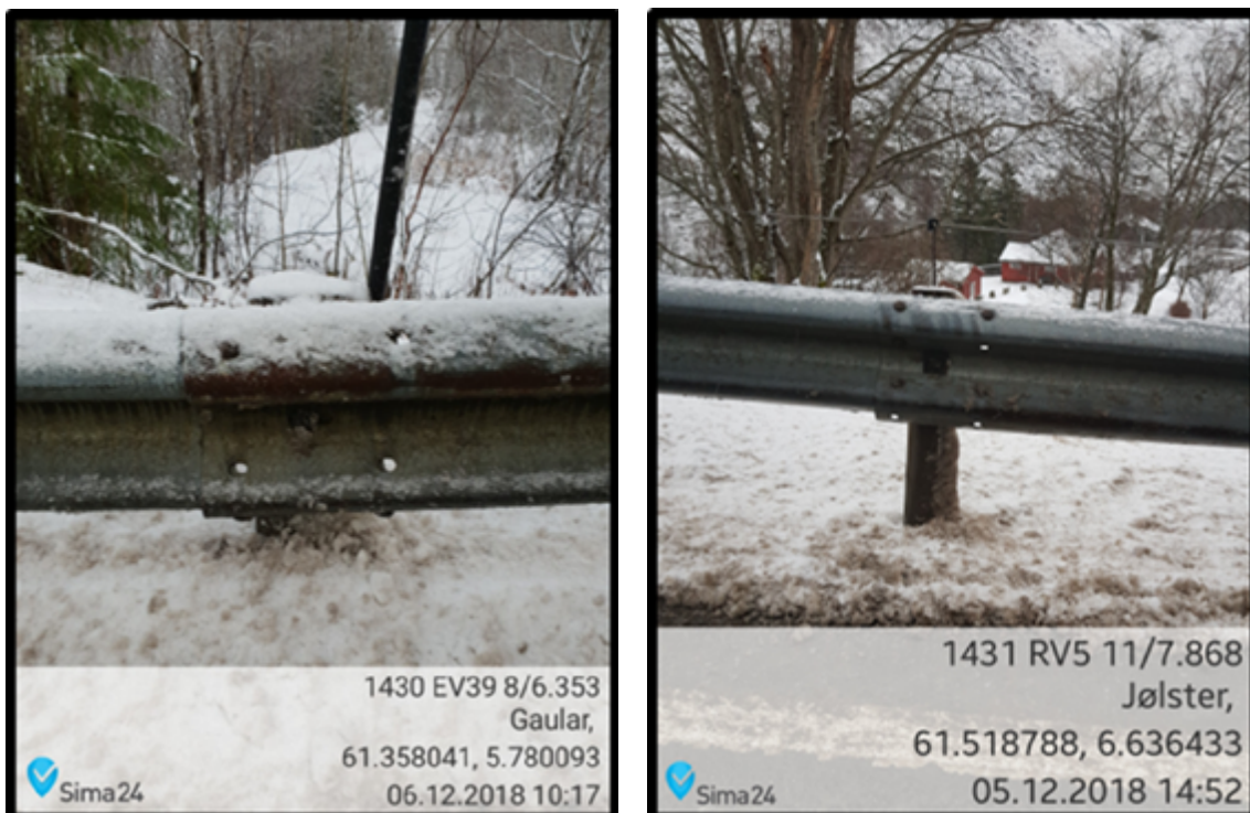
Bilde 1 og 2: Manglende bolter i rekkverk Ev 39 Gaular og Rv 5 Jølster
