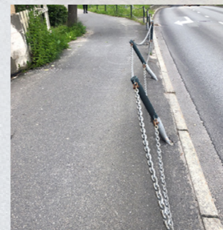
Skada rekkverk. Ikkje i samsvar med krav til rekkverk.
