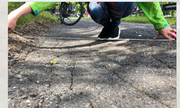
Ujamnheit på tvers på gang- og sykkelvegen. Ikkje i samsvar med krav til vegdekke/fast dekke.
