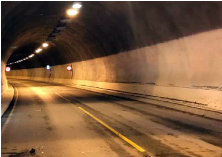
Bilde 3: Eksisterende vegmerking inne i tunnelen er slitt eller nedsmusset. Bildet viser manglende merking på høyre side.
