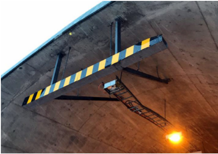
Bilde 7: Flere knuste lysarmaturer. Noen bærer preg av å ha vært knust lenge. Ett armatur manglet. Skade på kabelbru ved høydehinder, Hammerfest side, er ikke utbedret.
